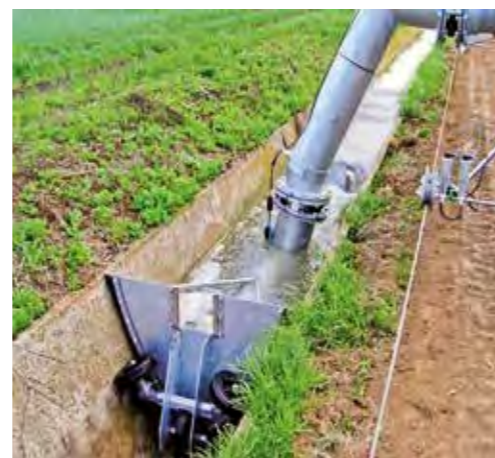
Conducto de aspiración con compuerta de retención
